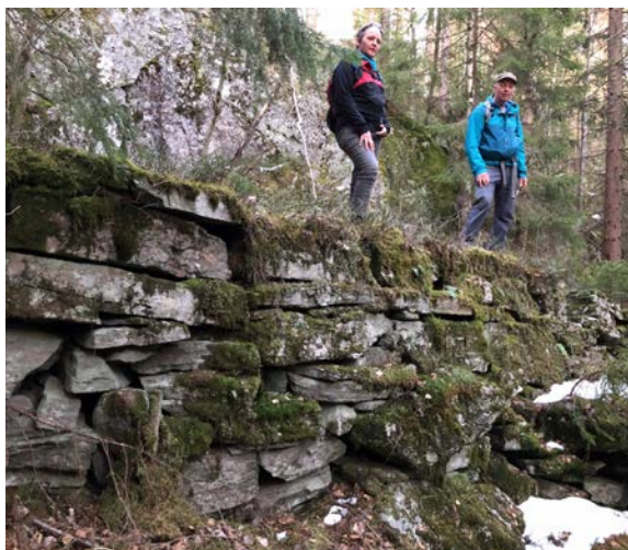
Berit Norum og Espen Bratlie inspiserer den flotte oppbyggingen langs Plankeveien nord for Kruggmyr, som ligger mellom Nøklevann og Elvåga. Deler av muren er i ferd med å rase ut. Foto: Lars Rogstad.
