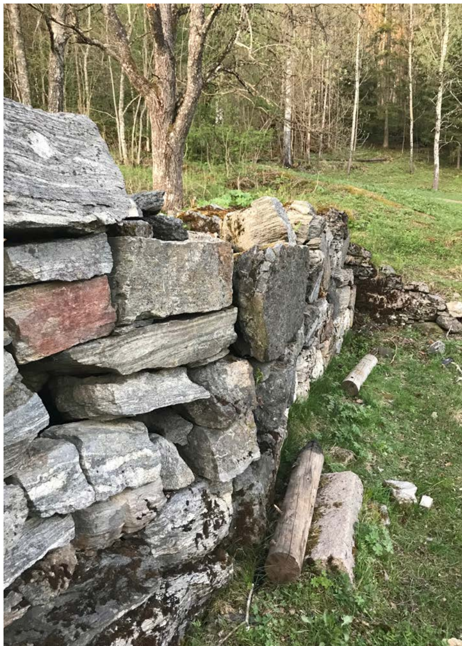
Muren som er i ferd med å rase ut. Oktober 2021. Foto: Lars Rogstad
