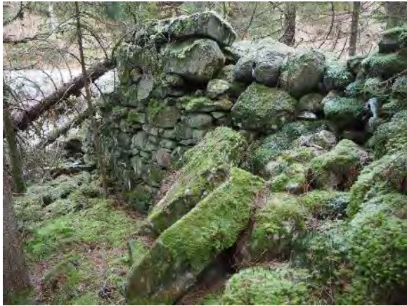
Rester av demning ved Skjelbreia. Foto: Bjarne Røsjø
