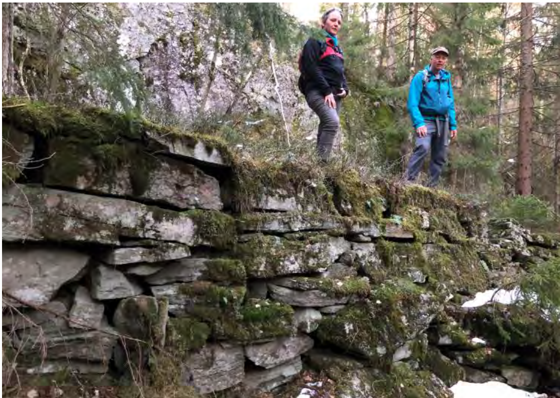
Oppbygginger for Plankeveien nord for Kruggmyr. Deler av muren er i ferd med å rase ut.
