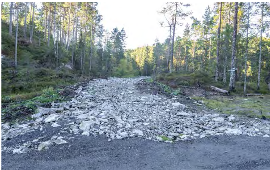
ØV mente at landbruksveien over ei myr på Hektneråsen var ulovlig anlagt og ikke skulle ettergodkjennes. Foto: ØV.
