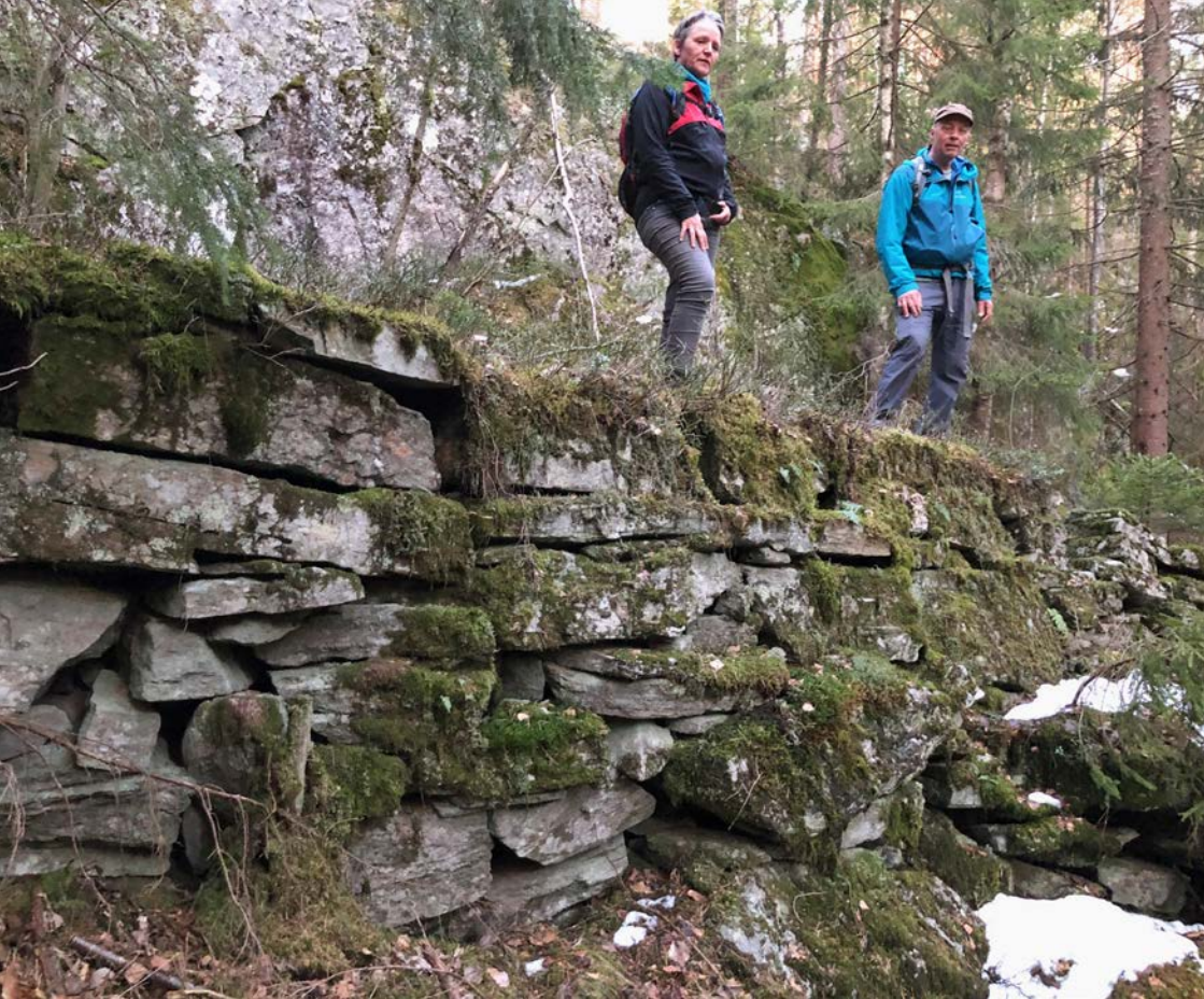
Berit Norum og Espen Bratlie inspiserer den flotte oppbyggingen langs Plankeveien nord for Kruggmyr. Deler av muren er i ferd med å rase ut. Foto: Lars Rogstad.
